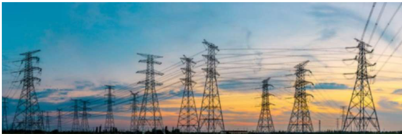
Мал. 19.1. ЛЕП — лінії електропередач
